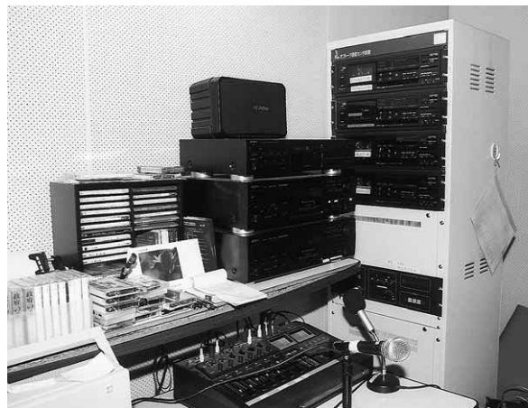
老朽化が激しい役場のセンター装置
