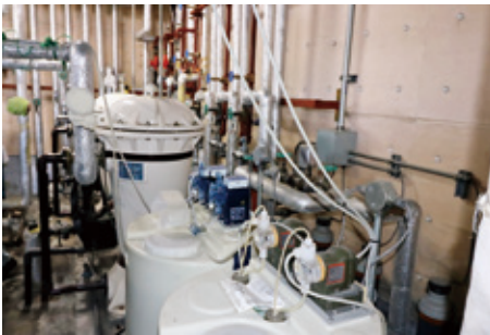
温泉センター機械室
