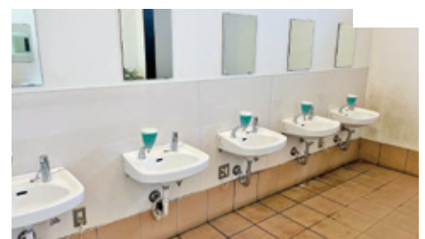
道の駅トイレ
