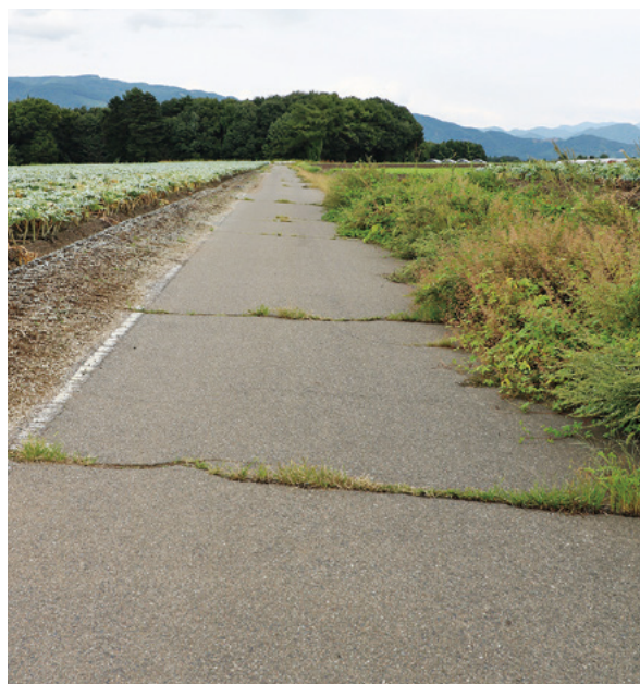
ひび割れた道路
