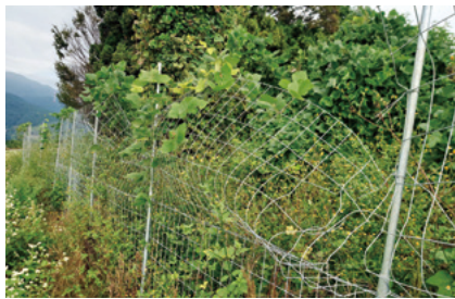
熊に壊されたフェンス
