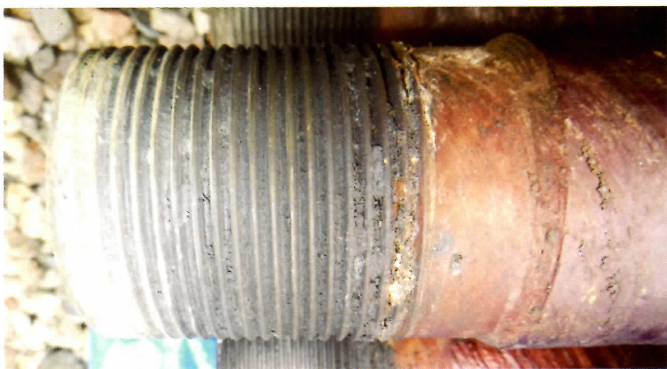
経年劣化により破損したねじ山
