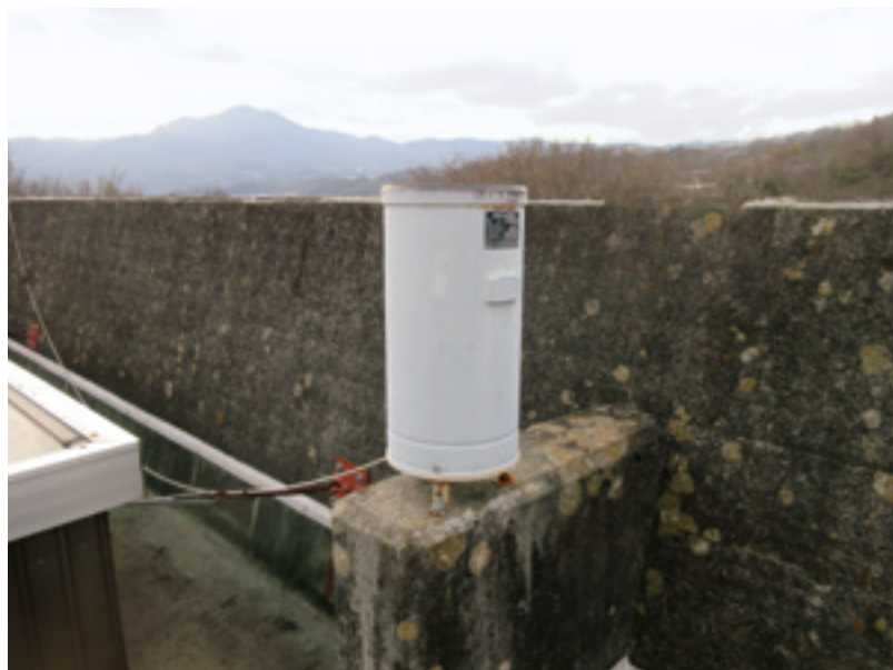
役場屋上に設置されている雨量計
