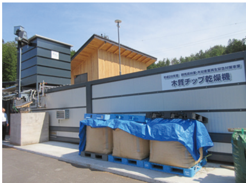
ウッドビレッジ川場 木質チップ乾燥機
