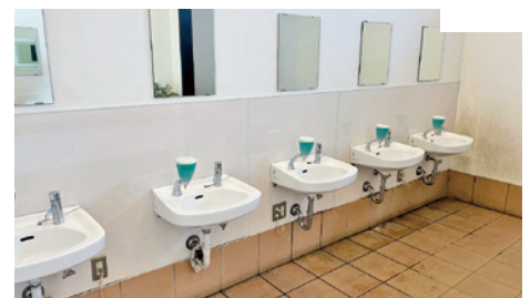
道の駅トイレ
