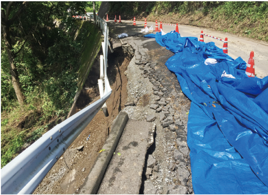
豪雨災害により損壊した道路
