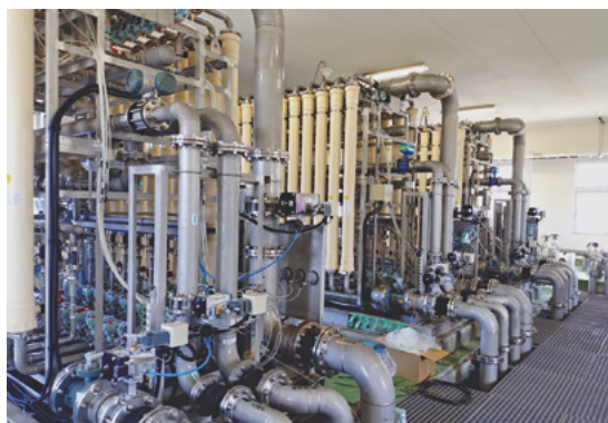
東部簡易水道浄水場 膜ろ過施設
