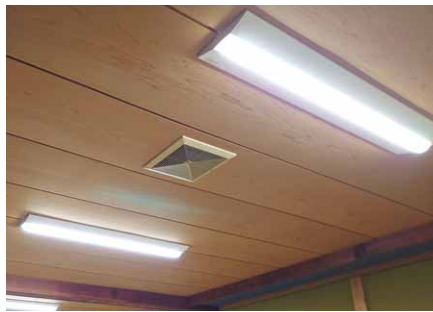
照明器具も交換
