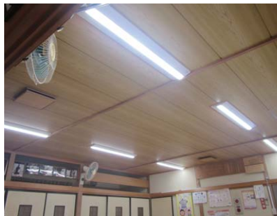
照明器具も交換
