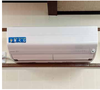
新しく設置されたエアコン
