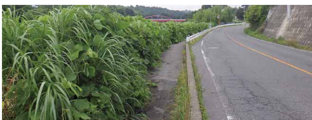
草木が生い茂り通りにくかった歩道(糸井地区)
