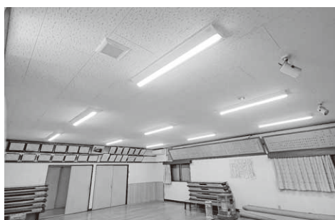
下宿区住民センターに整備された電灯
