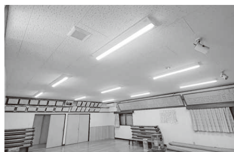
下宿区住民センターに整備された電灯
