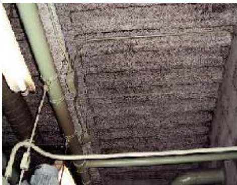
石綿含有吹付けロックウール
