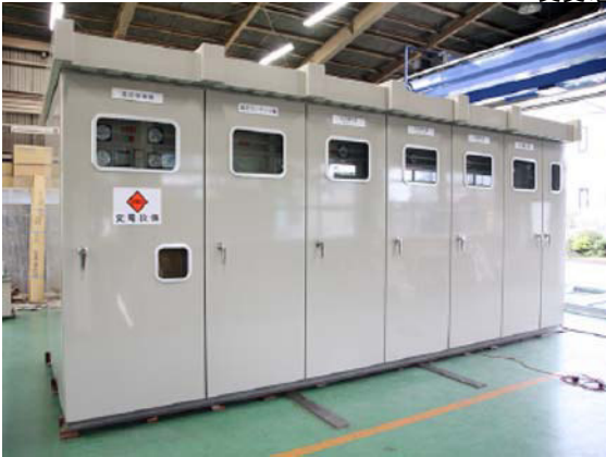
受変電キュービクル
