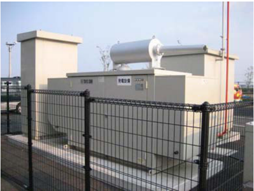
非常用発電機
